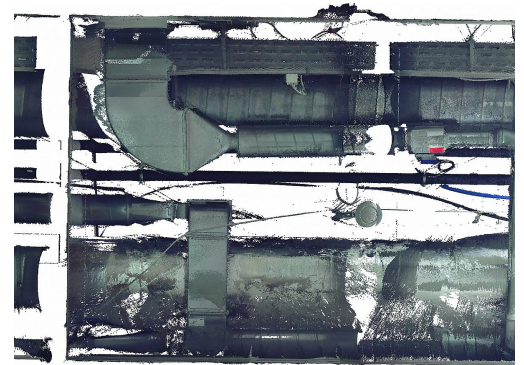
Aufnahme der Gebäudetechnik
